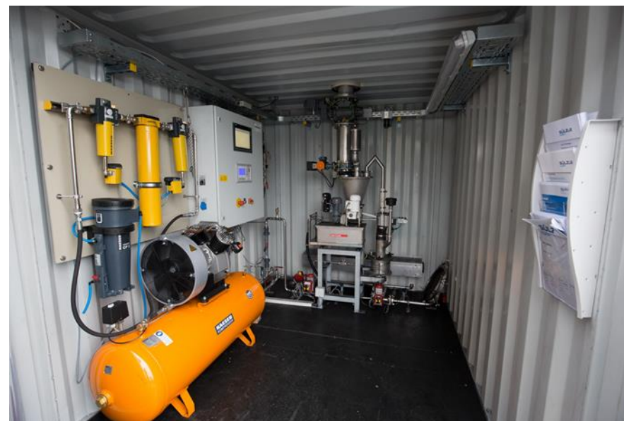
Figuur 1. Binnenzijde PACAS proefinstallatie
